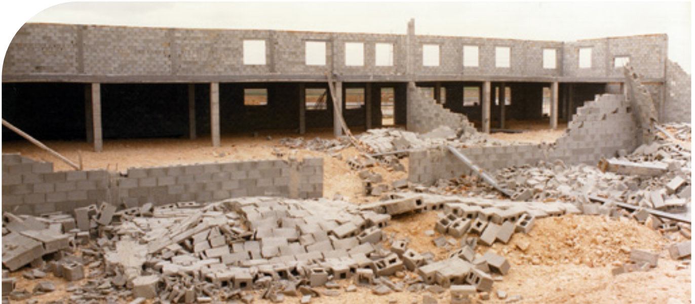
Edificación derribadas por temporal de viento.
